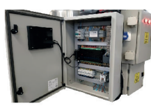
SISTEMAS DE MONITOREO Y CONTROL REMOTO
